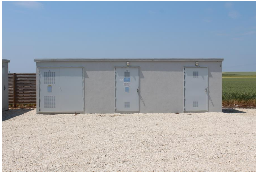
Figure 10 : Illustration des postes de livraison envisagés pour les parcs éoliens des Bouchats (source : Epuron, 2015)
